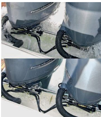
Figura 3 – Montaggio errato: Il bracket si allaga in fase di pre-planata
